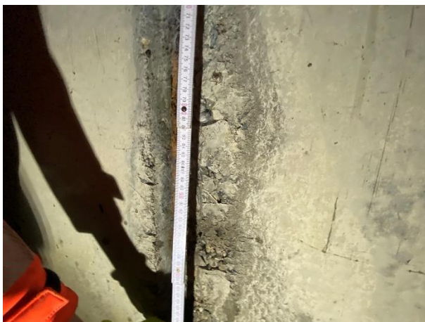
Abb. 2: Kleine Kiesnester im Bereich der Fugen
